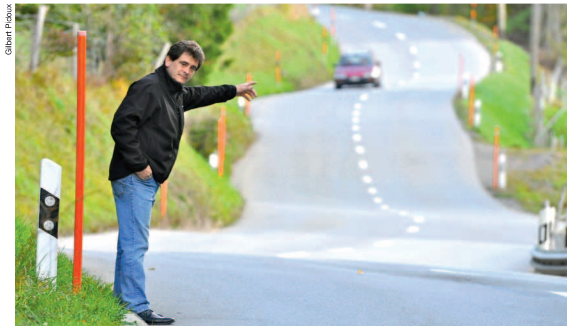
L'ingénieur EPFL Claude-Alain Davoli (Service des Eaux du Canton) sur la fameuse route de La Frasse, déformée par le glissement. Et qui s'est déplacée de 110 m latéralement, depuis 1840.
